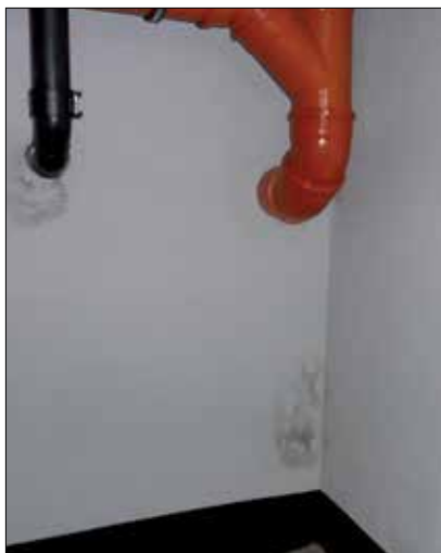
▲ Fot. 2. Przecieki punktowe na skutek nieprawidłowego zabezpieczenia miejsc przebieg instalacyjnych (fot. archiwum autorów)
