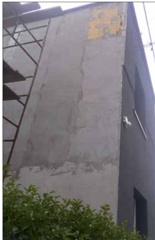
Fot. 5. ► Brak zastosowania siatki w warstwie zbrojonej
