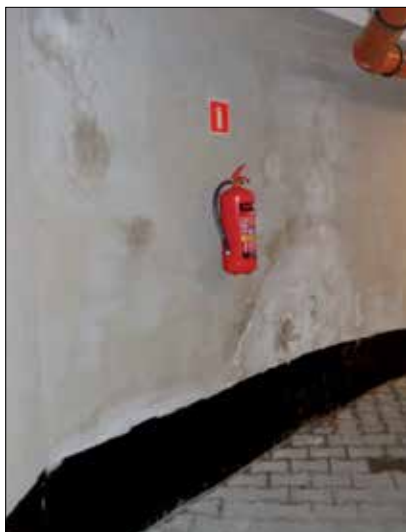
▲ Fot. 1. Zawilgocenie ściany wynikające z braku prawidłowej izolacji (fot. archiwum autorów)
