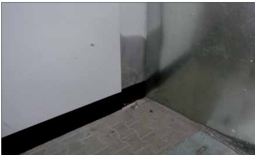
▲ Fot. 3. Zawilgocenia wynikające z braku ciągłości izolacji w węźle konstrukcyjnym (fot. archiwum autorów)
