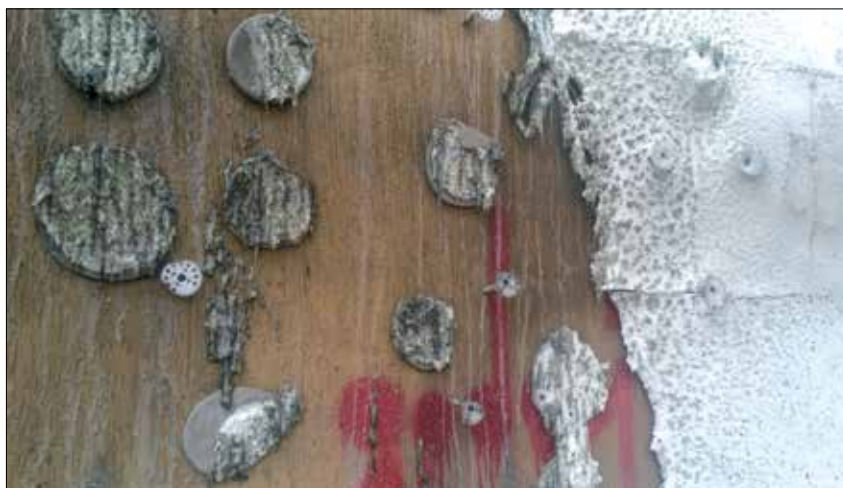
Fot. 3. ► Nieprawidłowe klejenie styropianu uszkodzonego wskutek pożaru
