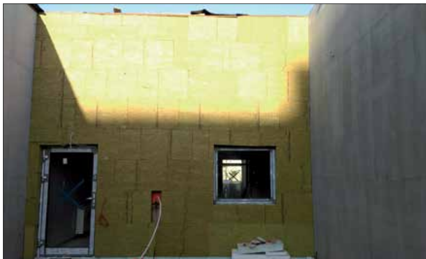
Fot. 2. ► Brak zabezpieczenia warstwy termoizolacyjnej przed oddziaływaniem warunków atmosferycznych
