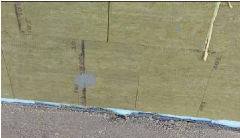
◀ Fot. 4. Nieprawidłowe wypełnienie szczelin między wełną mineralną za pomocą pianki poliuretanowej
