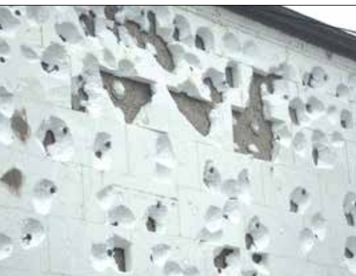
◀ Fot. 1. Uszkodzenie izolacji termicznej wskutek aktu wandalizmu
