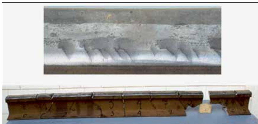
▲ Fot. 4. Przykład wad kontaktowo-zmęczeniowych na powierzchni toczonej szyny oraz widok wielokrotnego spękania szyny [7]
