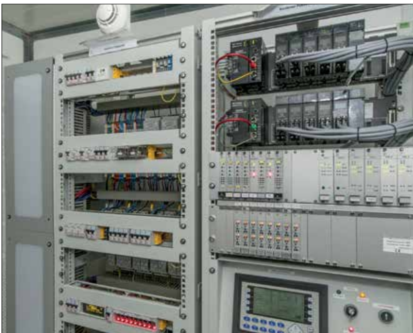
▲ Fot. 3. Przykładowe wnętrze kontenera systemu ssp (RASP-4F)
