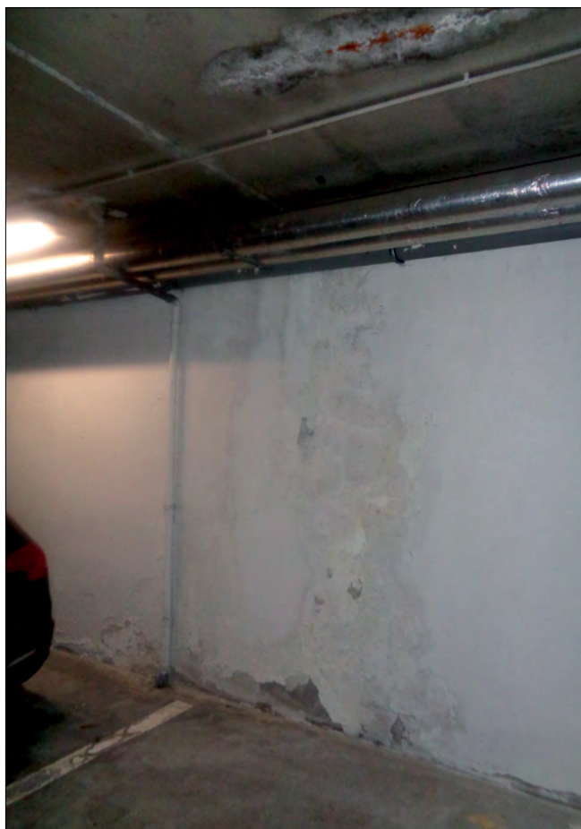
Fot. 1. Skutki braku prawidłowej hydroizolacji – przecieki przez ściany i strop garażu podziemnego
