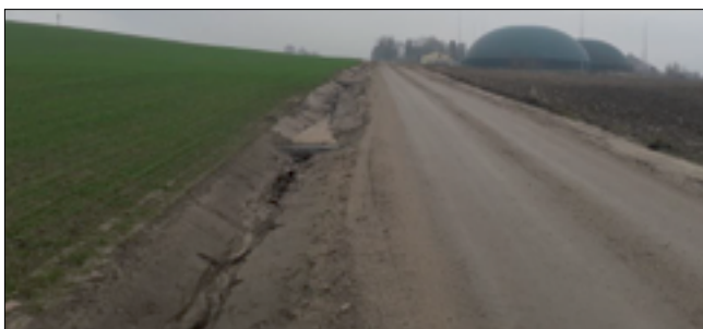
Fot. 2. Uszkodzenia dna rowu przez opady
