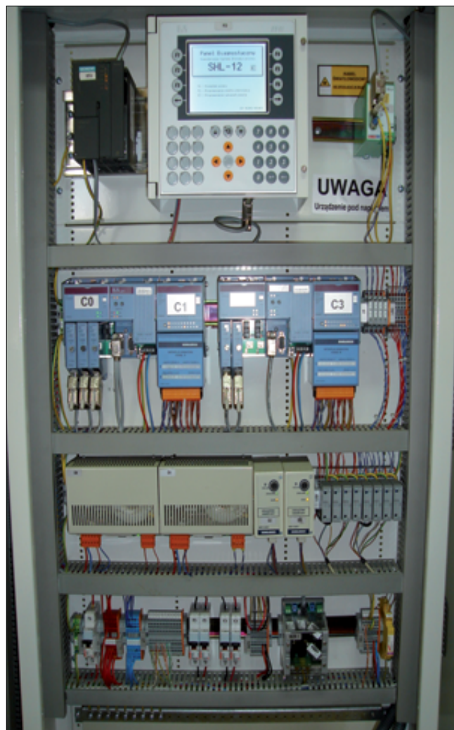
Fot. 3. Elementy komputerowego systemu blokady liniowej (źródło własne)
