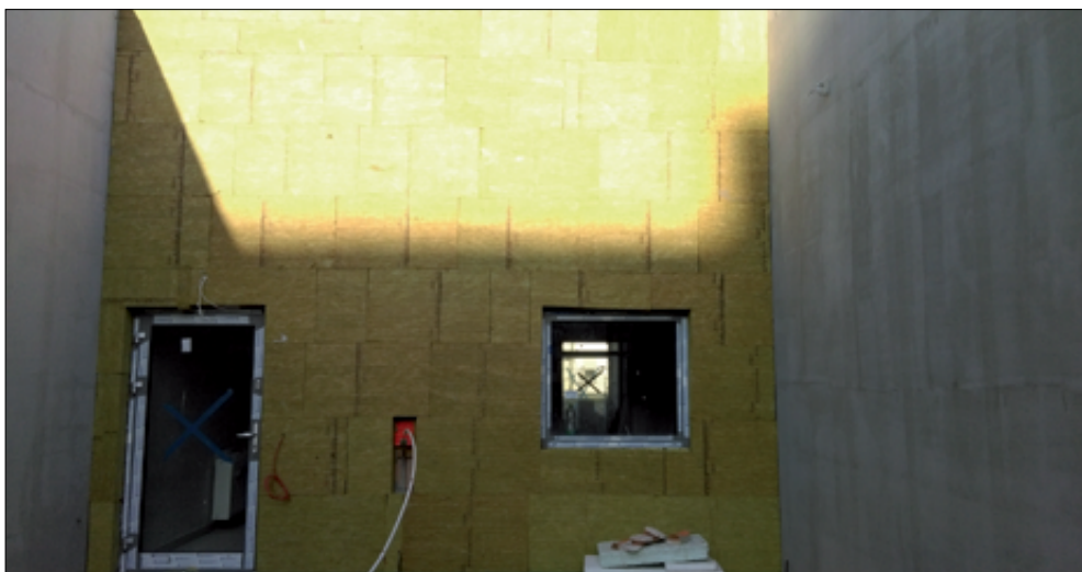
Fot. 1. Brak zabezpieczenia warstwy termoizolacyjnej przed oddziaływaniem warunków atmosferycznych
