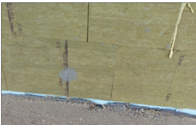
Fot. 3. Nieprawidłowe wypełnienie szczelin między wełną mineralną za pomocą pianki poliuretanowej
