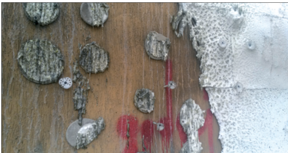
Fot. 2. Nieprawidłowe klejenie styropianu uszkodzonego wskutek pożaru
