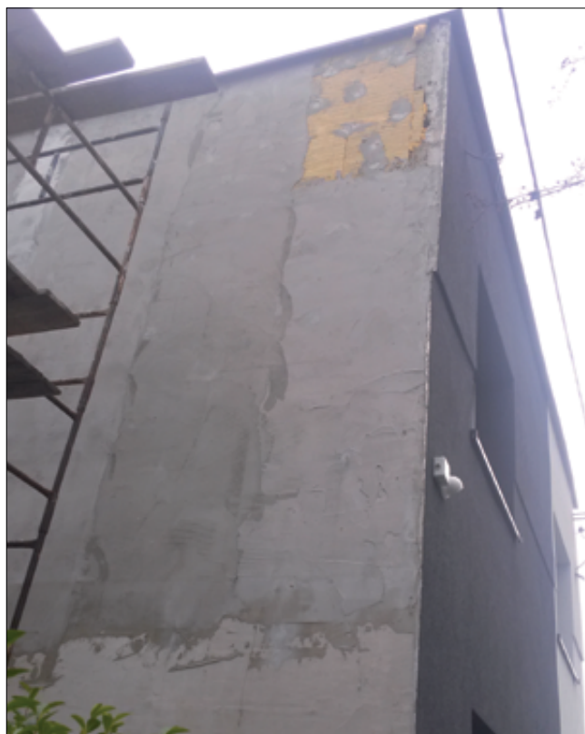
Fot. 4. Brak zastosowania siatki w warstwie zbrojonej
