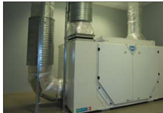
▲ Fot. 2. Centrala rekuperacyjna z wbudowaną pompą ciepła
