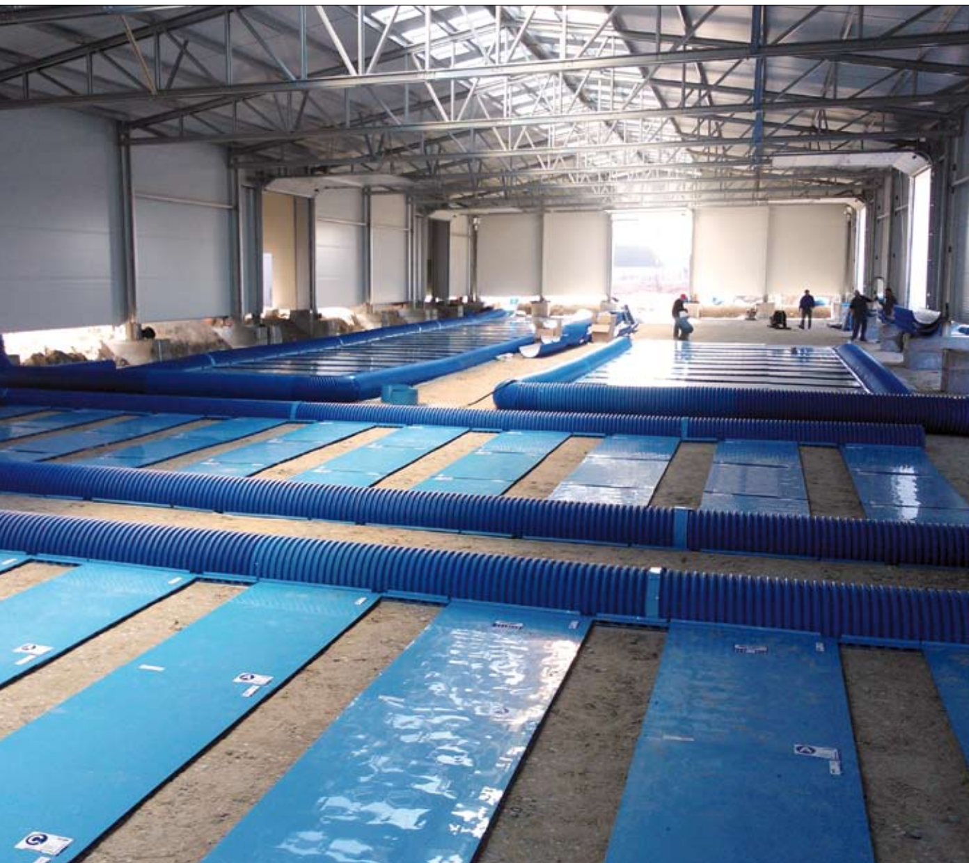
▲ Fot. 1. Gruntowy wymiennik ciepła PROVENT GEO zainstalowany w obrysie fundamentowym hali produkcyjnej
