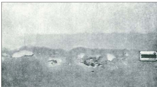
Gable wall of building in Rzeszów with visible spots of heavy dampness following immediately the application of horizontal damp insulation using the crystalline injection method in July 1987. At the ground level there are holes drilled in the wall. (Ściana szczytowa budynku w Rzeszowie z widocznymi plamami silnego zawilgocenia bezpośrednio po wykonaniu izolacji poziomej metodą iniekcji krystalicznej®, lipiec 1987 r. Na poziomym terenie widoczne otwory iniecyjne w murze).
